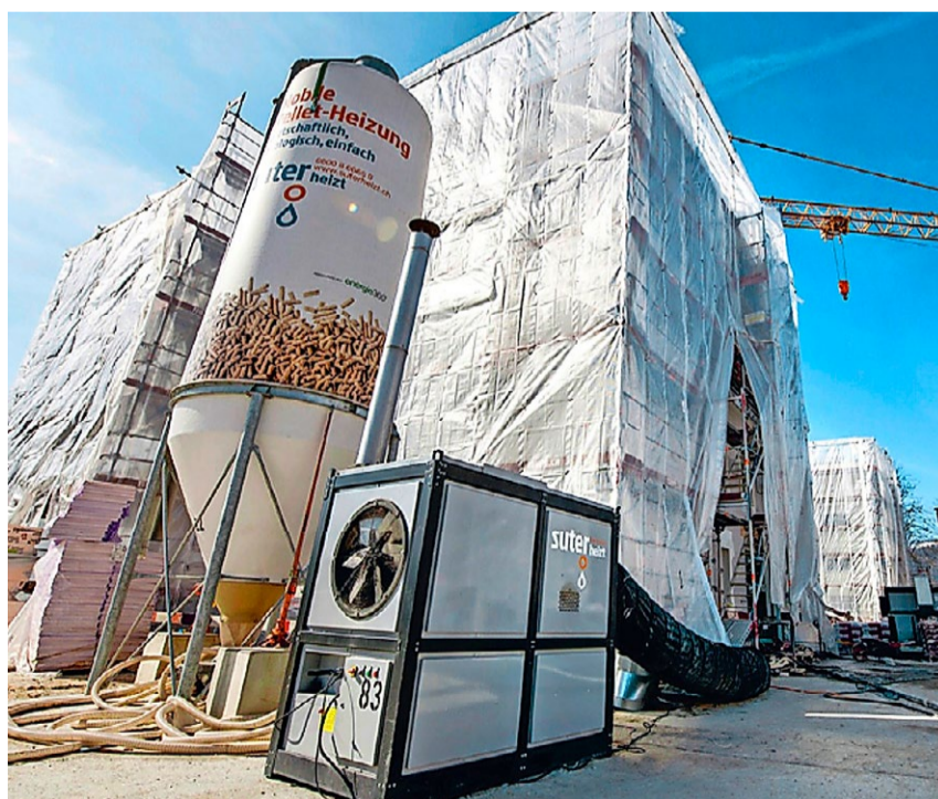
Mobile Warmluft-Heizung mit Holzpellets im Einsatz für die Beheizung des Fassadenbereichs. Über den gleichen Pelletsilo lassen sich zusätzliche Heisswassermodule für den Innenbereich koppeln. z.V.g.
